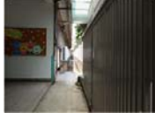
4. 修齊樓南門：圍牆縫隙
